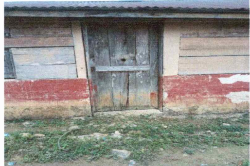
Foto 2: La cocina requiere repacion en toda su estructura
